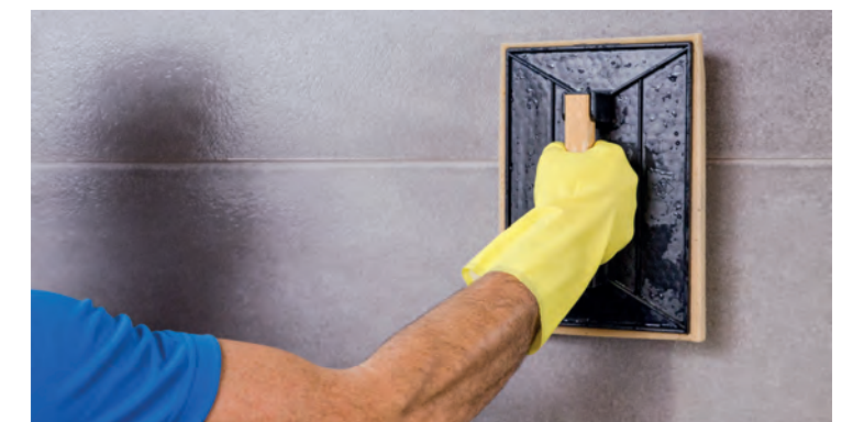
Remove any leftover grout and other dirt | Elimina los residuos de junta y demás suciedad | Éliminer les résidus de joints et autres saletés | Entfernen Sie Fugematerialreste und andere Verunreinigungen
